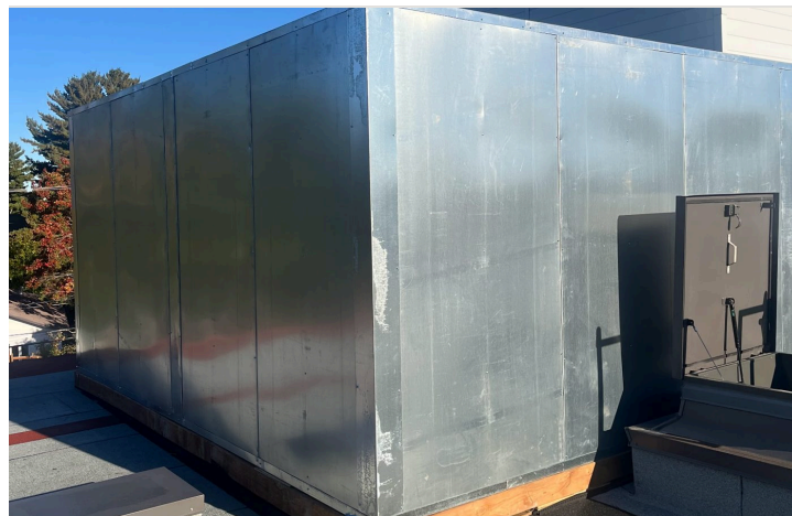
Mur acoustique installé autour d'un équipement mécanique en toiture.
